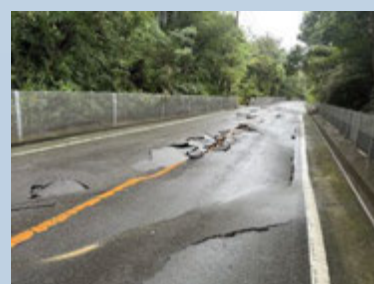
大雨で地盤が緩み道路が陥没し使用不能に
