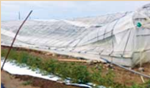
【R3 台風6号】 令和3年7月に襲来した台風6号では、沖縄全域に被害を及ぼした。写真は、台風にとまなう、竜巻被害と思われるハウス施設。
